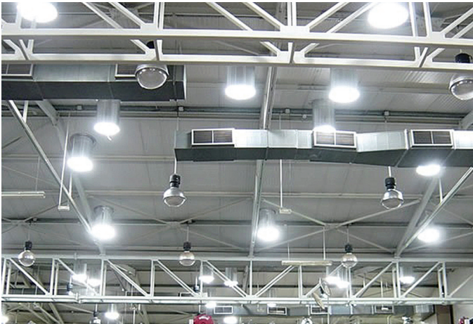
Рисунок 5. Освещение производственного цеха полыми световодами
