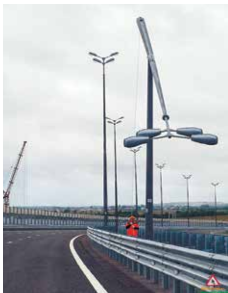
Складываемые опоры. М-20, Ленинградская область
