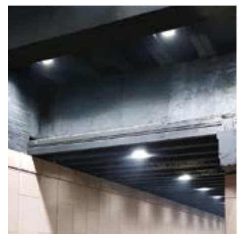
Освещение тоннеля на проспекте Месропа Маштоца
