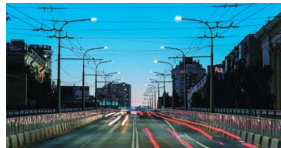
Улицы Волгограда, освещенные светильниками МСК «БЛ ГРУПП»
